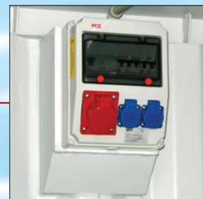
Cassetta di distribuzione con prese integrate all'interno del container
