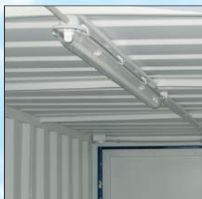
Neon fissati al tetto ed interruttore accanto alla porta
