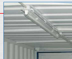
plafoniere con interruttore antiumido
